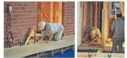
検査官たちは念入りに破損箇所をチェック。関係者も建物に近づき、大きな衝撃後の様子も測定で確認する。
